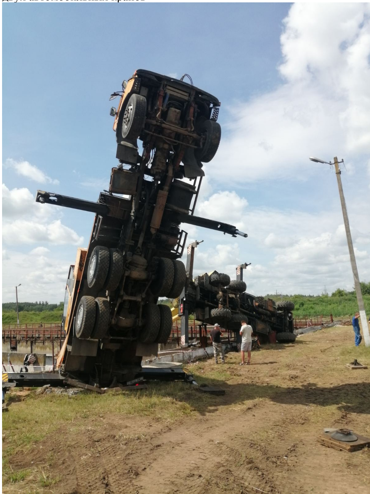
Фотографии 2 июля 2023 года при производстве работ по опусканию строительного телескопического погрузчика «Manitou» с применением двух автомобильных кранов
