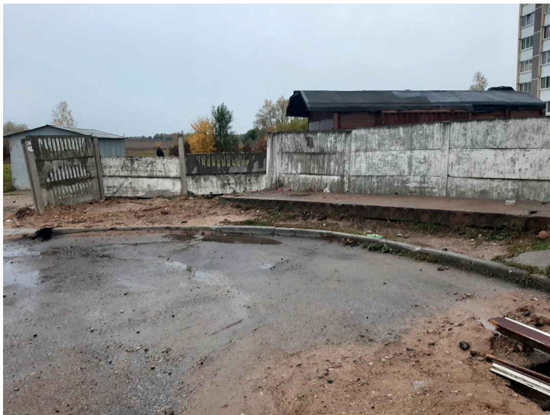
Рисунок 2.1 Пример повреждения ограждения на контейнерной площадке по ул. Стародворецкая, 3 в г.п.Большая Берестовица
